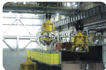
プラ容器包装クレーン
